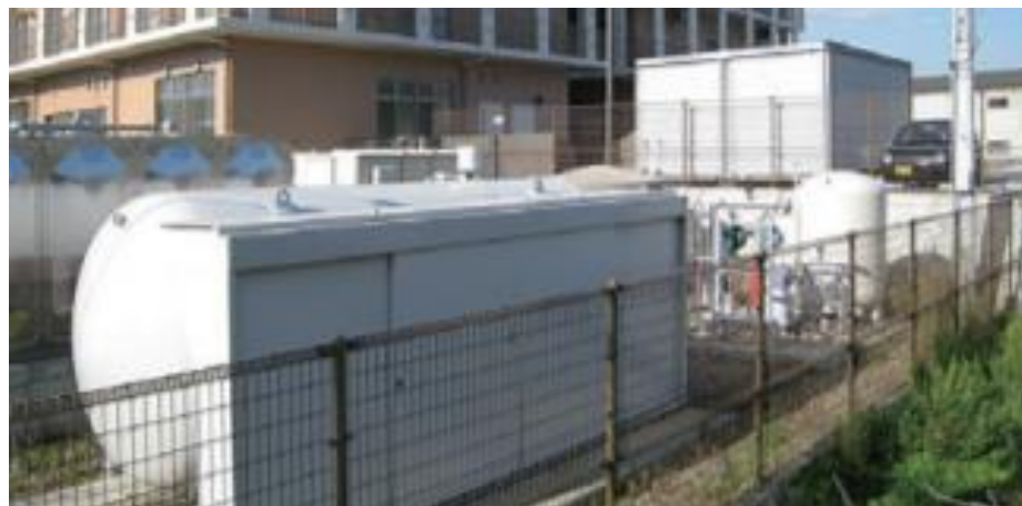
福祉施設（スプリンクラー設備）
