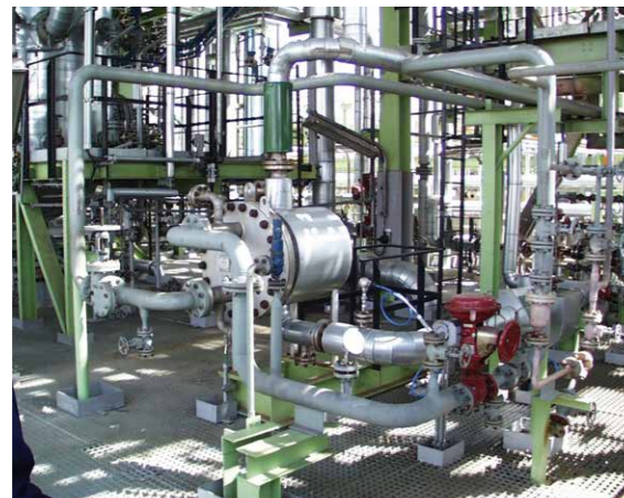
■エバポレータ 4350kW (製薬プラント)
