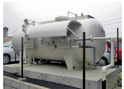
商業施設(屋内消火栓設備)
