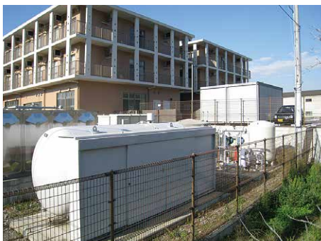
福祉施設(スプリンクラー設備)
