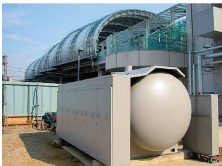
駅施設(スプリンクラー設備)
