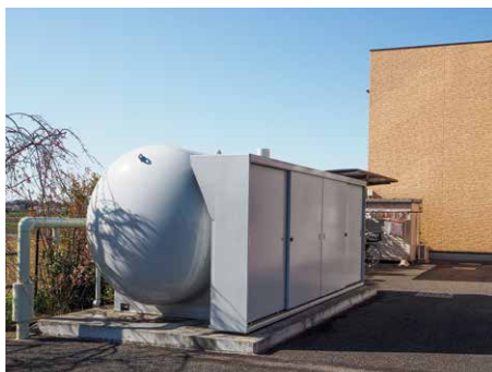
医療施設(スプリンクラー設備)
