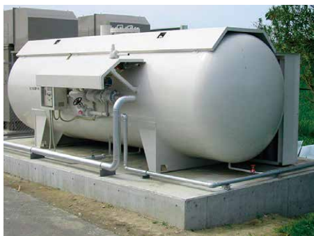
食肉センター(屋外消火栓設備)
