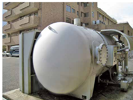
救護施設(スプリンクラー設備)
