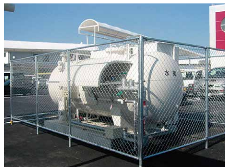
商業施設(屋内消火栓設備)
