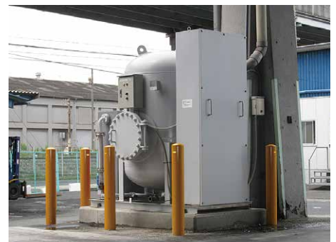
公共施設(泡消火設備-任意設置-)
